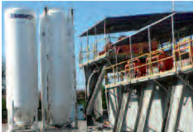
Uso geotérmico en planta cementera (Alemania)
