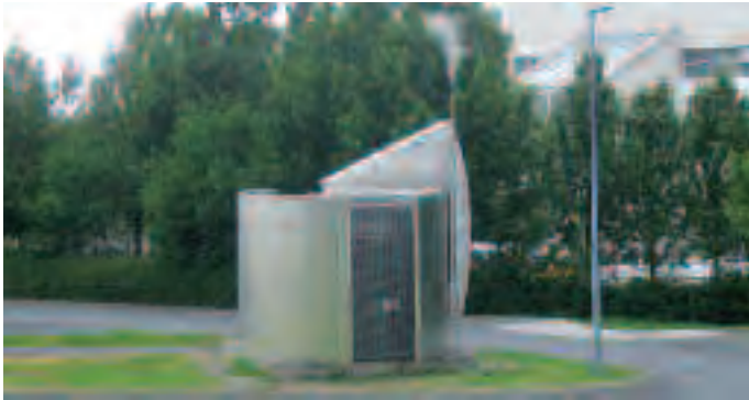
Casetas que cubren las antiguas perforaciones geotérmicas usadas para calefacción en Reykjavik (Islandia), hoy en día interconectadas al sistema general de distribución de calor extendido a toda la ciudad
