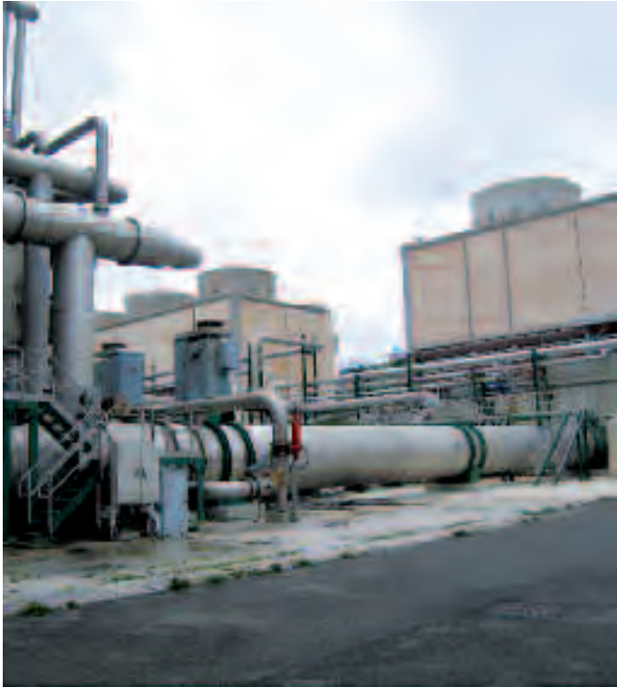
Central geotérmica actual de Larderello (Italia)
