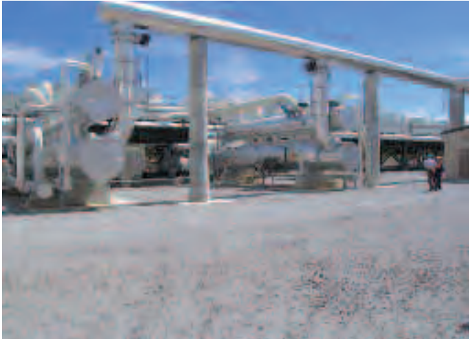
Planta geotérmica ciclo binario de Mokai 2 (Nueva Zelanda)
