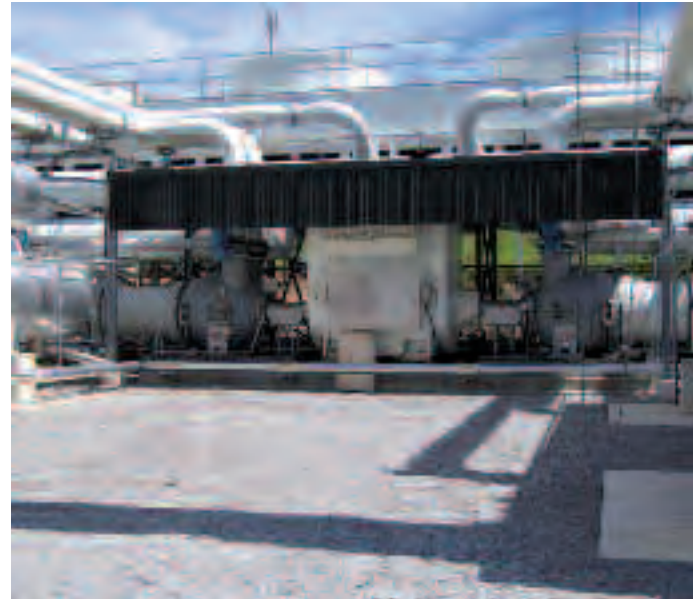
Planta geotérmica ciclo binario de Mokai 2 (Nueva Zelanda)
