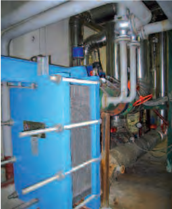
Sistema de calefacción de distrito en París. Fuente Petrathern
